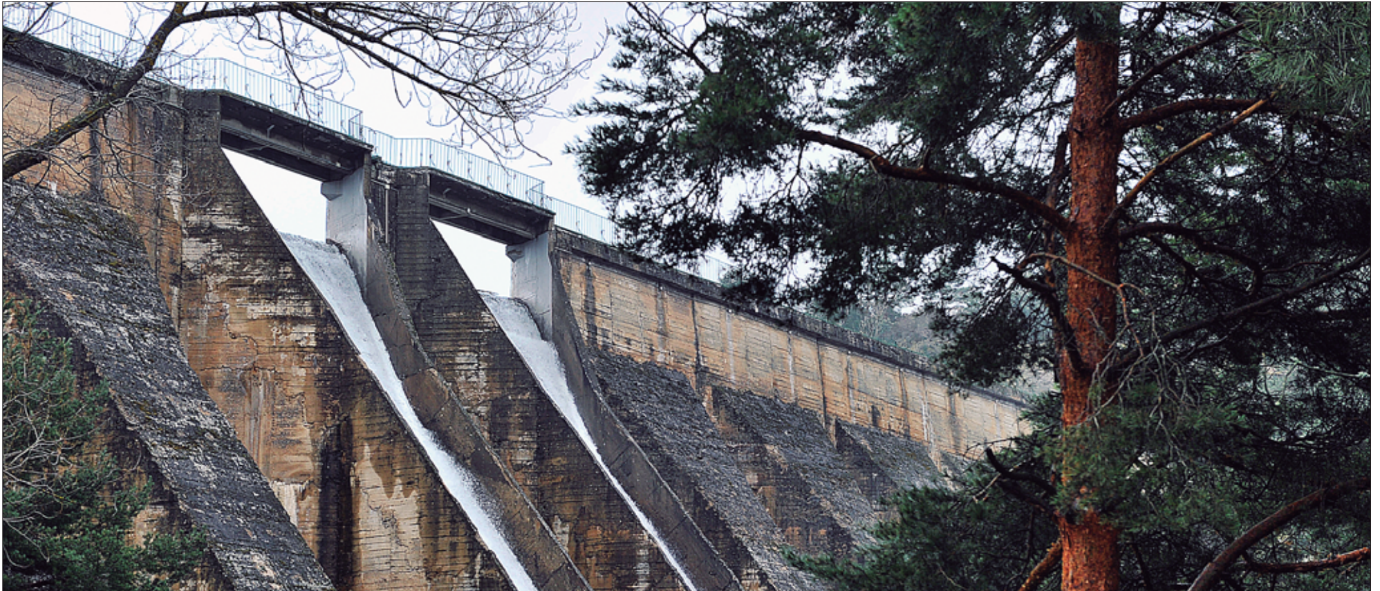
Los redactores del anteproyecto, que han diseñado tres alternativas de recrecimiento de Puente Alta, sostienen que la mejor es la que se sitúa más alejada de la actual pantalla, aguas abajo. / KAMARERO
