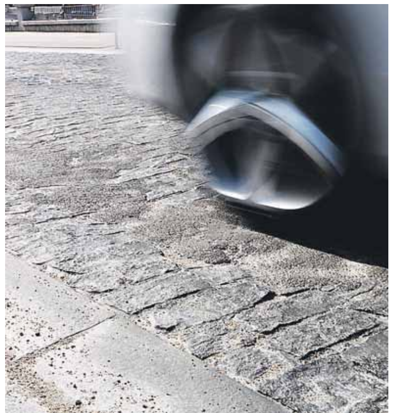
Los parches en el pavimento son perfectamente visibles. / LARA MAZAGATOS
