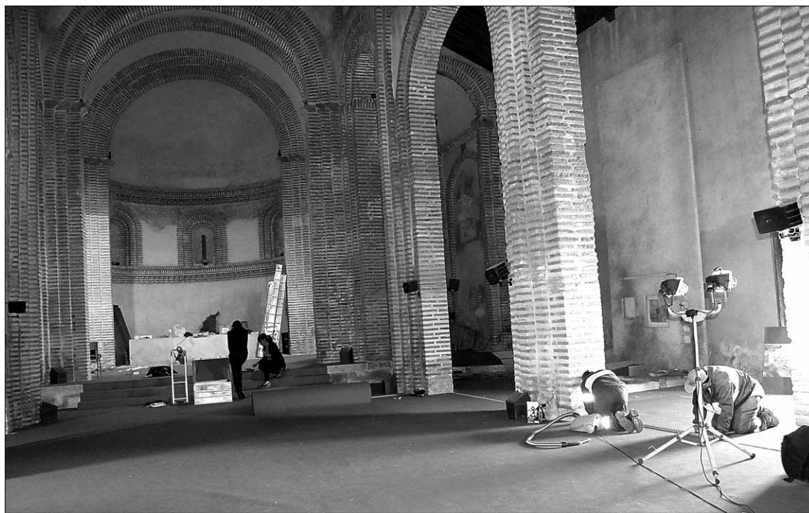
Técnicos y operarios municipales trabajan estos días en la renovación del Centro del Mudéjar. / NURIA PASCUAL
