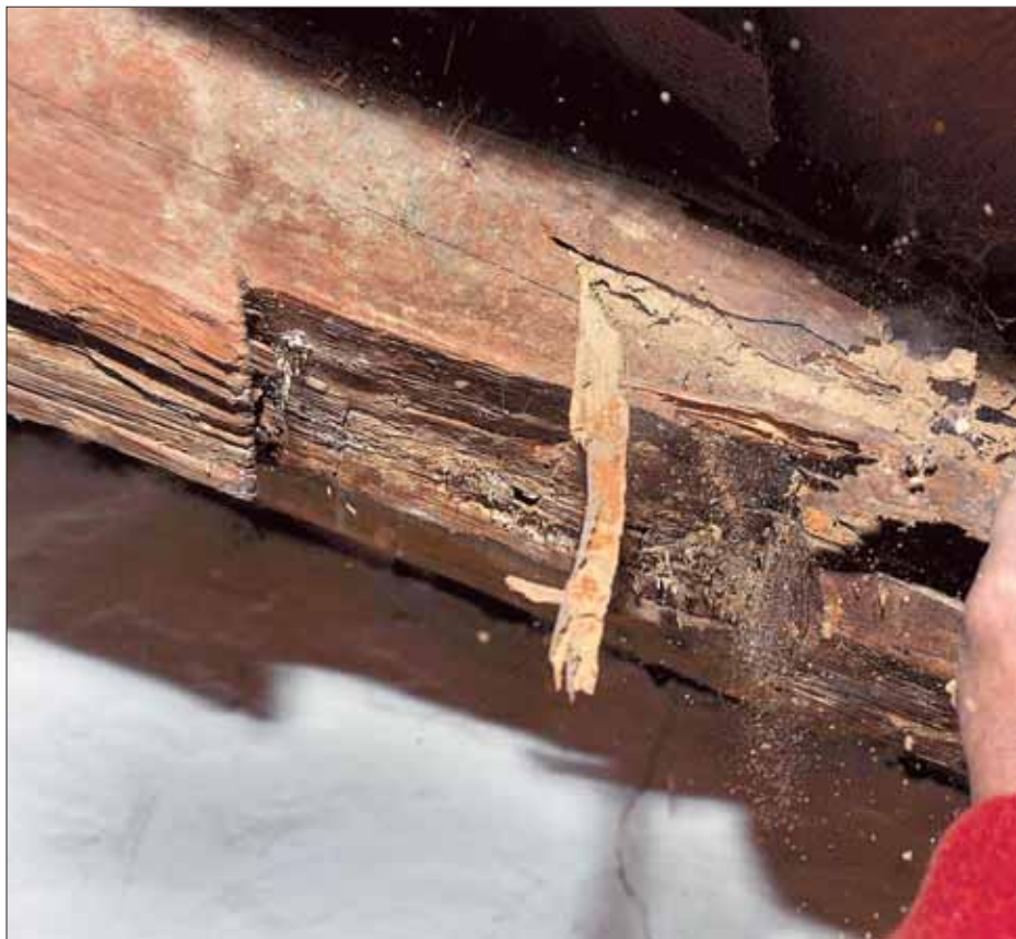
Imagen de una viga de sujeción del techo de una de las viviendas de Carbonero de Ahusín afectada por las termitas y en la que se puede co...
