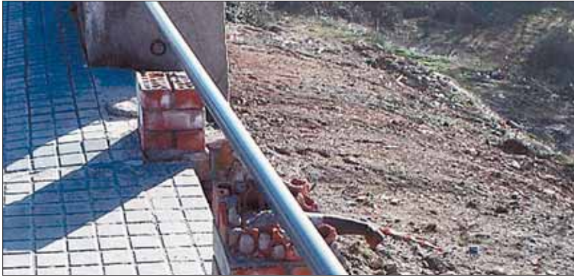
El PP alerta que el pretil, por su grave estado de deterioro, supone un riesgo para los vecinos de la zona. / EL ADELANTADO
