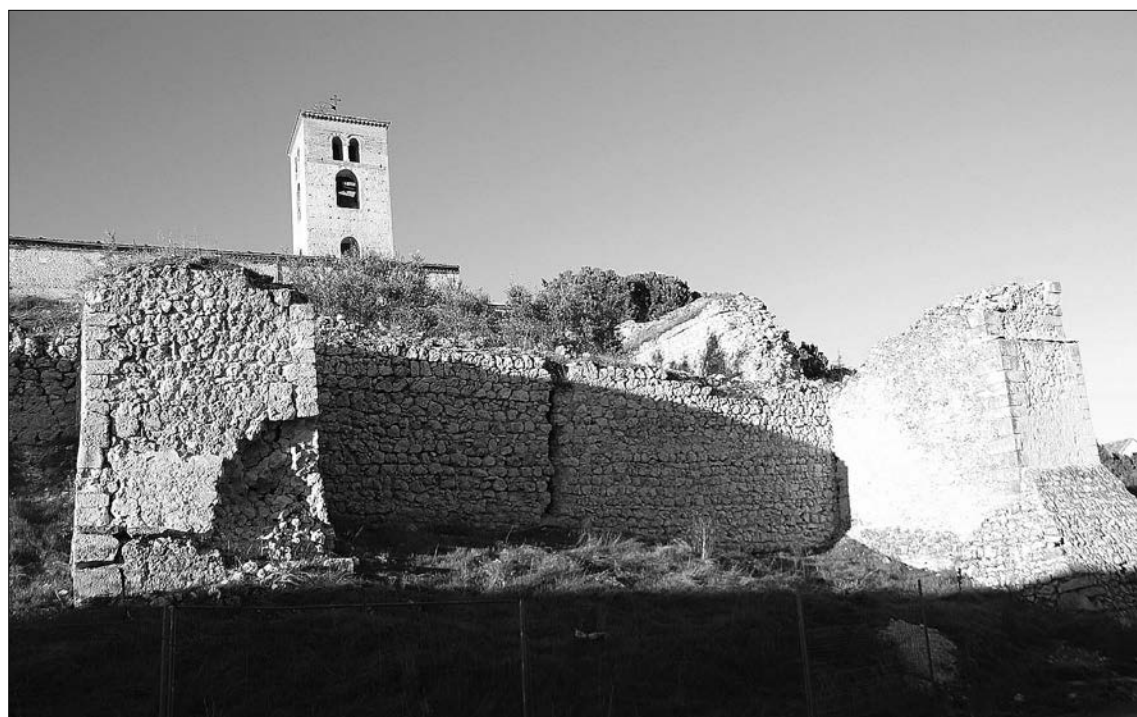
Estado actual del muro posterior del huerto de la iglesia de la Cuesta y de los contrafuertes. /GABRIEL GÓMEZ
