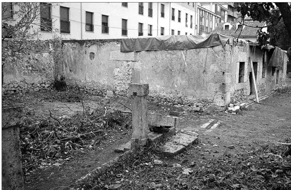
Estado actual del edificio de la calle Tenerías tras la actuación para evitar su derrumbe. /GABRIEL GÓMEZ
