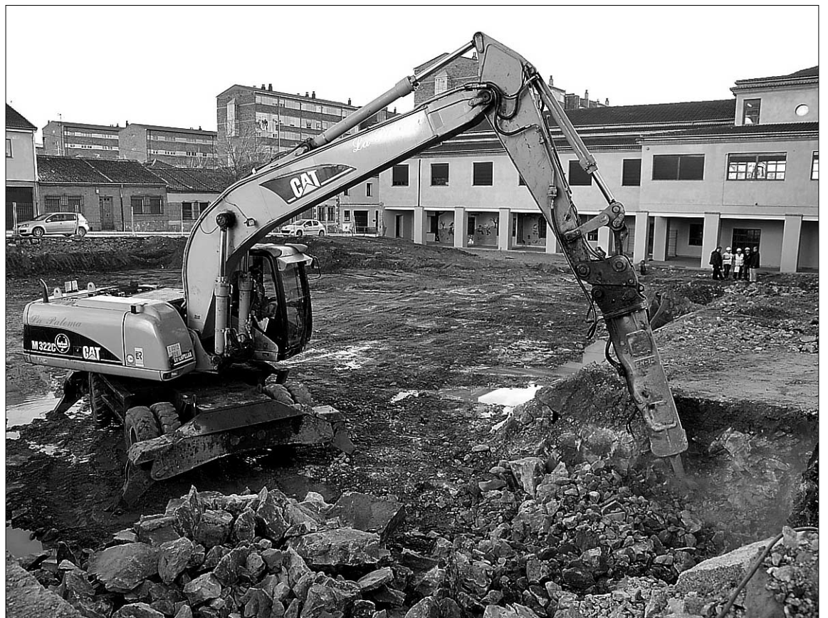
Las máquinas trabajan en el patio del colegio El Peñascal desde el pasado día 27 de diciembre. / ALBERTO BENAVENTE
