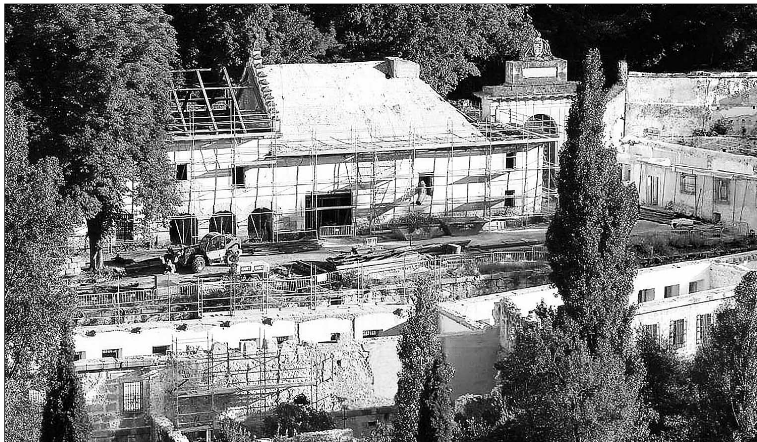
Los trabajos de rehabilitación del edificio industrial han eliminado ya los añadidos modernos que correspondían a la antigua fábrica de harinas. / EL ADELANTADO
