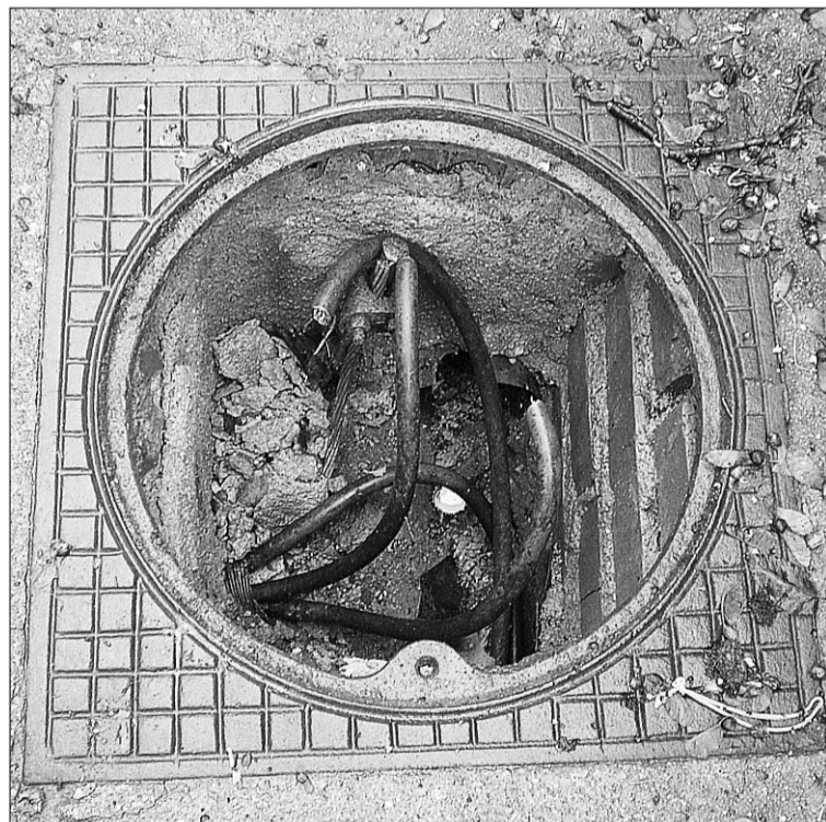
Las tapas de registro dejaron al descubierto los cables. /EL ADELANTADO
