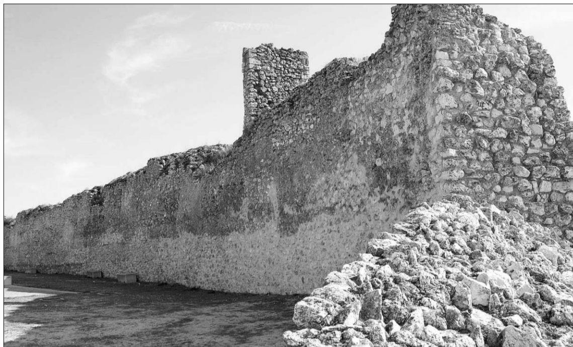
El Ministerio deberá supervisar el proyecto y preparar el pliego para adjudicar las obras./GABRIEL GÓMEZ
