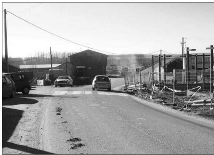
El Ayuntamiento denuncia la falta de señalización en las obras. / A. PINELA
