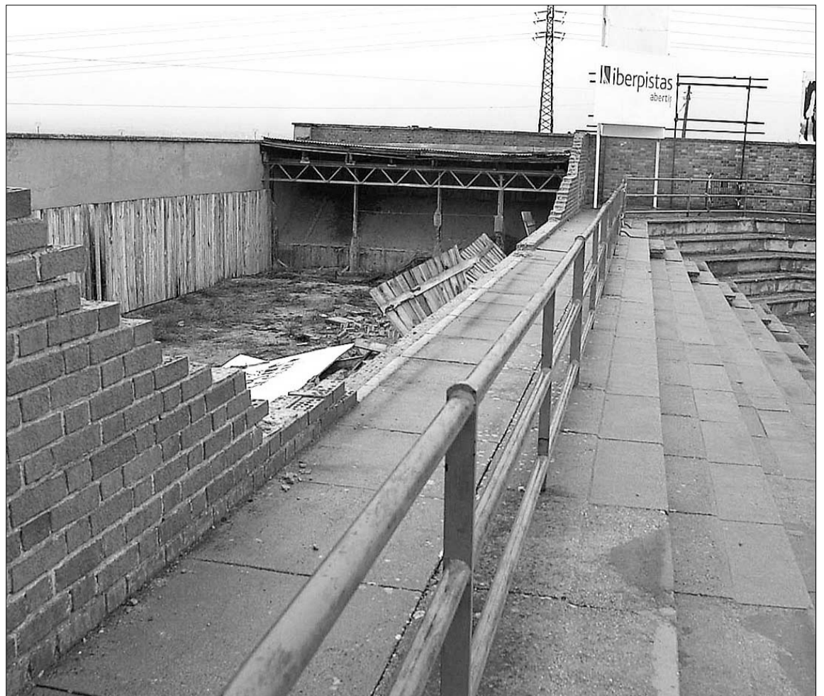
La zona del derrumbe del pasado fin de semana quedará acotada para el partido de la Segoviana./ JUAN MARTÍN
