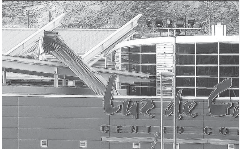
Imagen de una de las zonas dañadas de la cubierta, junto a la entrada principal, del centro comercial "Luz de Castilla"/KAMARERO
