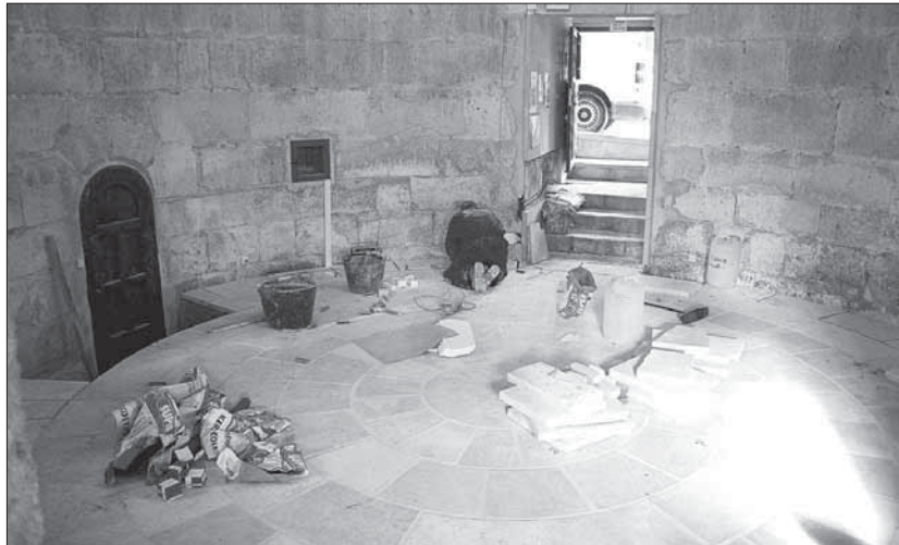
Estado actual de las obras que se están acometiendo en la Oficina de Turismo. / GABRIEL GÓMEZ
