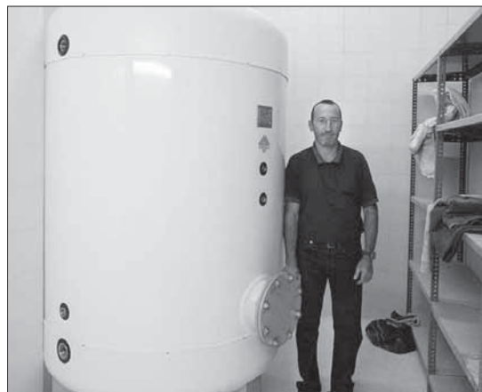
Pedro Casado, junto al nuevo tanque de agua caliente sanitaria./F. PEÑALOSA
