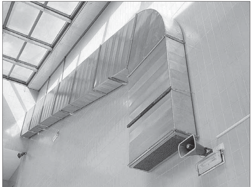
Parte de la infraestructura nueva instalada para la climatización de la piscina. /F. PEÑALOSA
