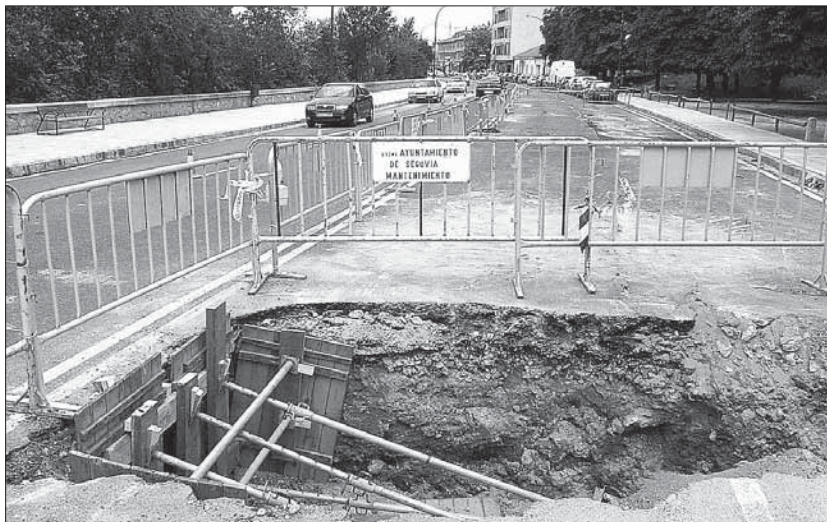
Los trabajos para restituir el colector en Vía Roma han obligado a levantar el asfalto. / JUAN MARTÍN
