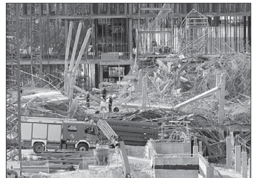
La estructura de hormigón quedó completamente derruida. / EFE
