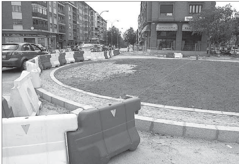
Los vecinos piden más agilidad en la ejecución de las obras de la rotonda en el barrio de El Cristo, JUAN MARTÍN
