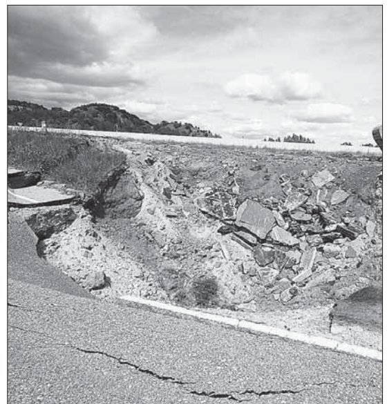
Imagen del socavón producido en la carretera A-1. J.F. PEÑALOSA
