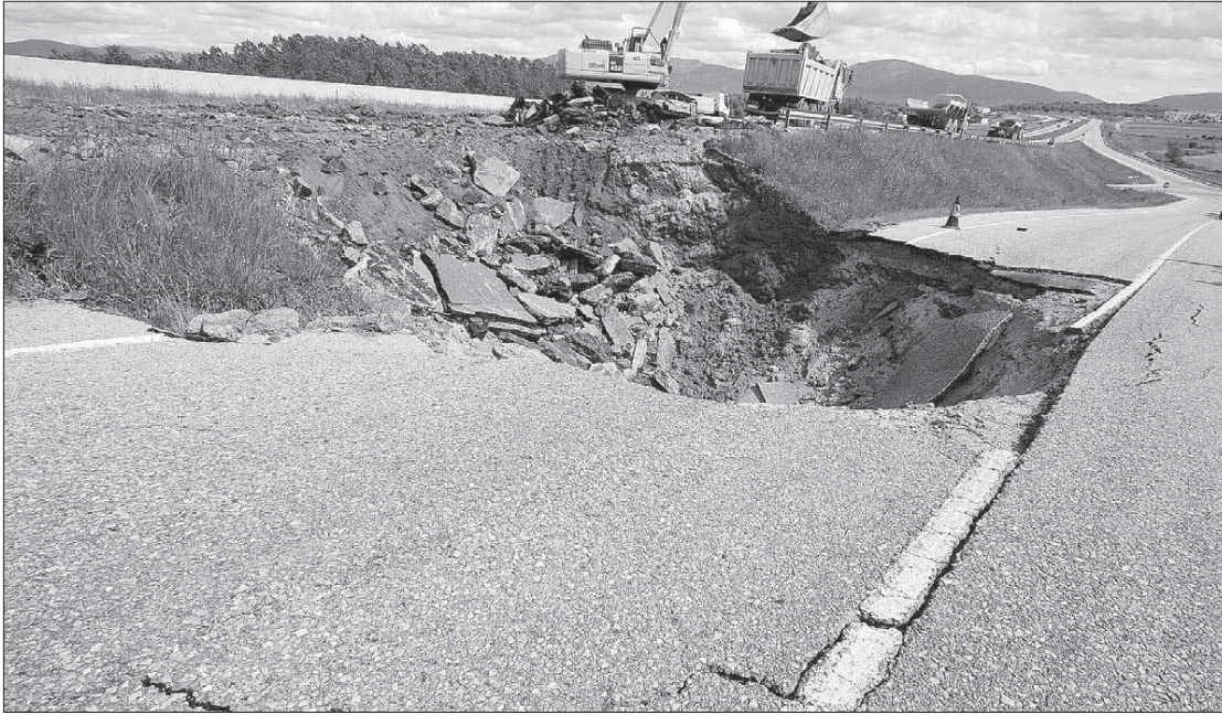
El desplome de la carretera afectó a los dos carriles de la carretera nacional sentido Madrid y a la salida a Castillejo y Sepúlveda. /F. PEÑALOSA
