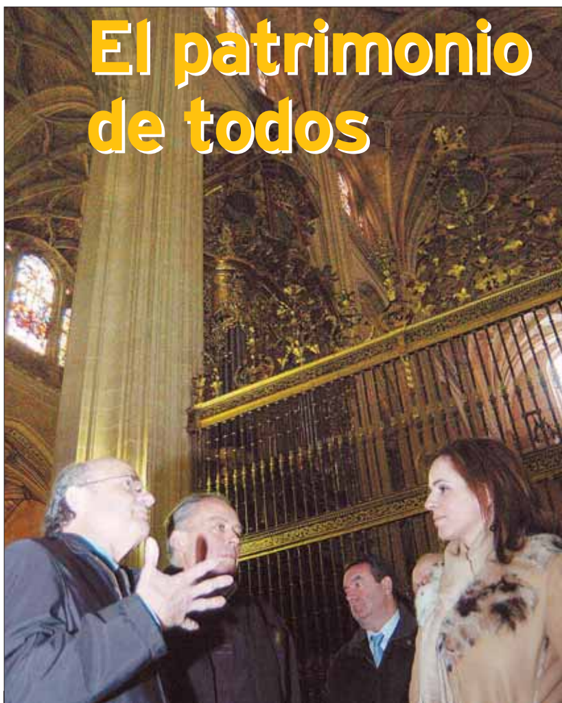
La consejera de Cultura observó "in situ" las obras de restauración del cimborrio. / KAMARERO
