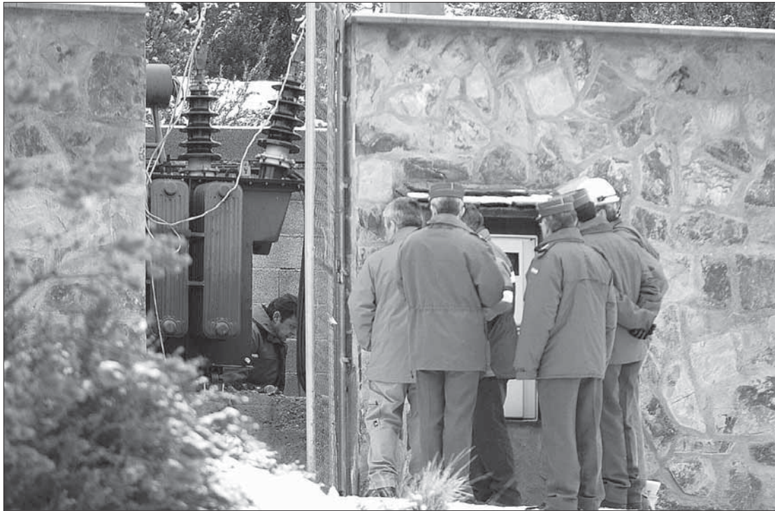
Efectivos de la Guardia Civil y operarios de Endesa inspeccionan las instalaciones de la central de distribución eléctrica donde se halló el artefacto. / PABLO OTIN (EFE)
