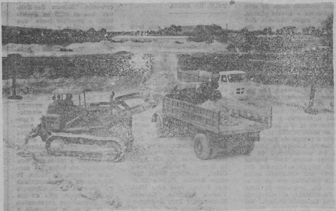
En la fotografia puede observarse que se trabaja activamente en la depuradora. Por el volumen de los camiones y máquinas puede deducirse perfectamente la profundidad que va tiene en estos momentos tras unos días de trabajos. Según nuestras informaciones la capacidad será suficiente para las necesidades del Manacor actual y del futuro.
