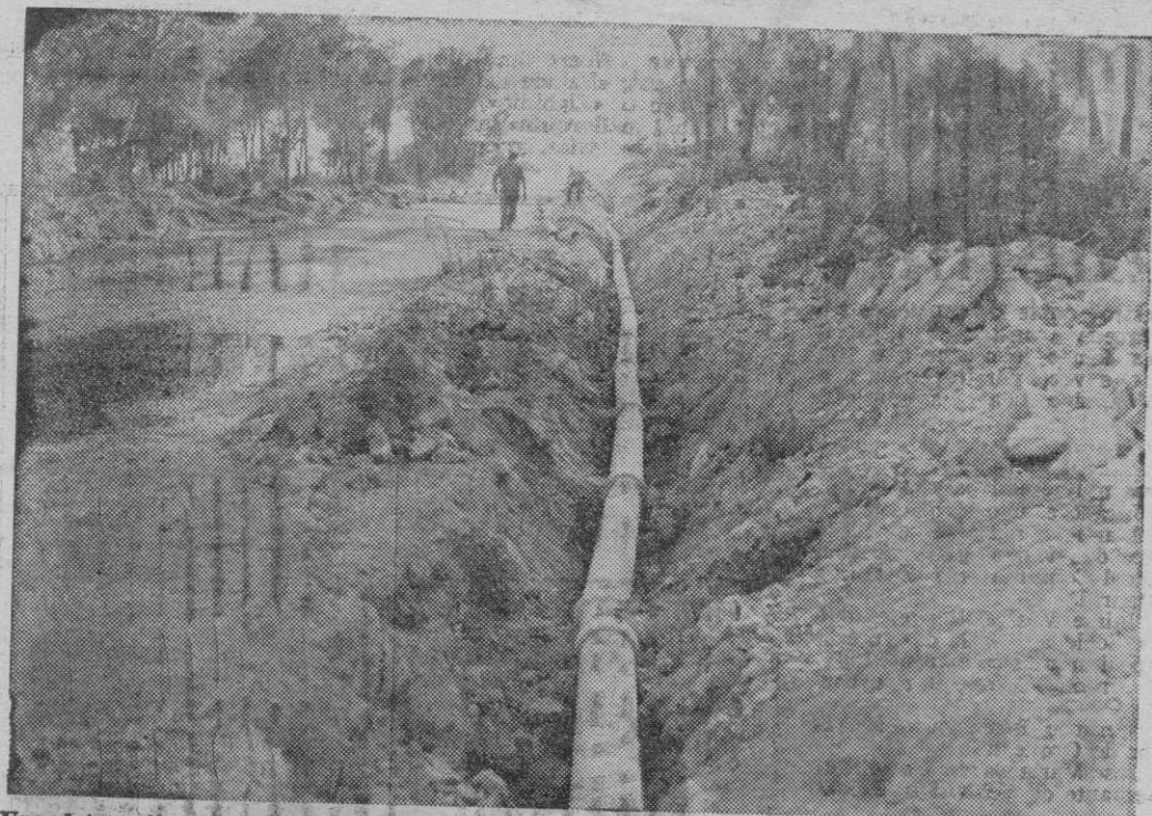
Una fotografía casi insólita de la Urbanización El Toro, en donde está localizado nuestro Primer Premio de la «Cesta de Navidad». Y explicaremos, o por lo menos lo intentaremos, de qué se trata. De tuberías, naturalmente, como salta a la vista. Resulta que en El Toro están prácticamente finalizadas las obras. Y ¿saben que, bajo tierra, perfectamente distribuidas por todo el terreno, existe una red de casi cien kilómetros de tuberías? Pues es cierto.
