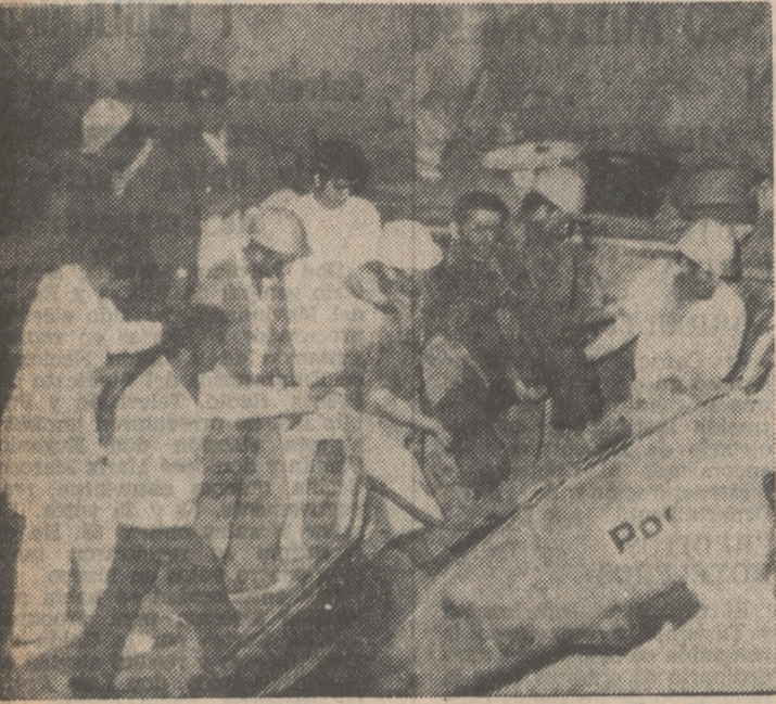
Este es el instante en que el obrero José González Ferrero es extraído con vida de entre los escombros del corrimiento de tierra producido cuando se trabajaba en las afueras de Pamplona en la construcción de un puente sobre el río Arga.
