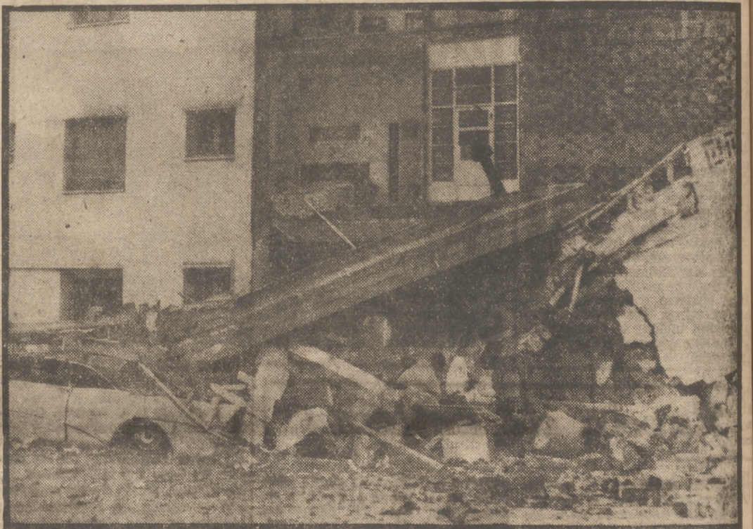
Entre muchos casos semejantes, el documento gráfico nos enseña cómo se desgajó parte de un inmueble dedicado a viviendas, cayendo buena parte de él sobre el coche que estaba a la puerta, hasta dejarlo en las condiciones que pueden contemplarse.
