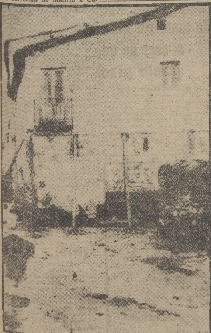
CIFUENTES (Guadalajara).—Esta casa hubo de ser apuntalada rápidamente para evitar su derrumbamiento. El temporal de lluvias ha sido causa de que se hundieran catorce casas y otras ochenta amenazan con las mismas consecuencias
