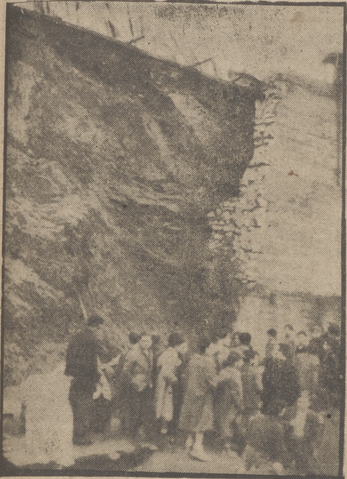
Aspecto que ofrecía el muro de contención de la carretera de Eibar, que, al derruirse por desprendimiento, produjo cinco muertos y tres heridos graves
