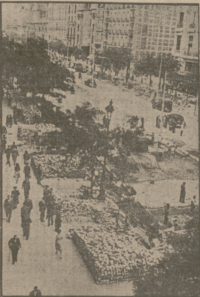
He aquí un aspecto de la madrileñísima calle de Alcalá, en la que se están llevando a cabo importantes obras de reforma, realizadas a un ritmo rápido, que promete verlas bien pronto terminadas
