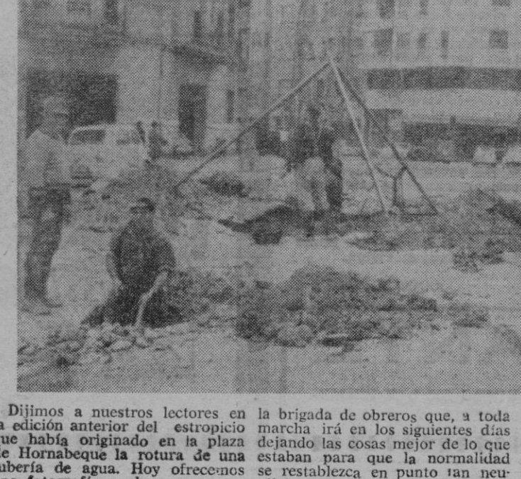
Dijimos a nuestros lectores en la edición anterior del estropicio que había originado en la plaza de Hornabeque la rotura de una tubería de agua. Hoy ofrecemos una fotografía en la que aparece la brigada de obreros que, a toda marcha irá en los siguientes días dejando las cosas mejor de lo que estaban para que la normalidad se restablezca en punto tan neurálgico para la circulación peatonal.
