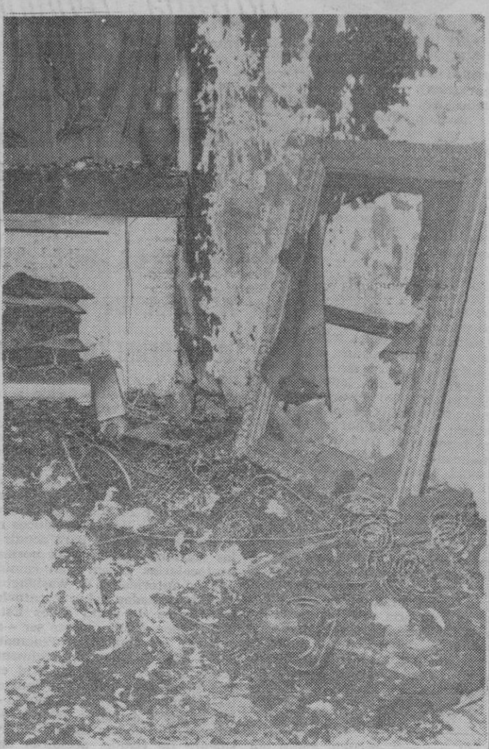
MADRID. — Por causas que se desconocen, la casa madrileña de Augusto Algueró y de Carmen Sevilla. El hogar de los famosos ha quedado prácticamente destruido por las llamas. En la foto, un aspecto del daño causado por las llamas. (FOTO CIFRA)
