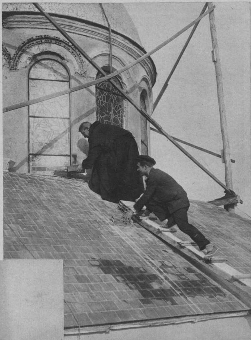
El Padre Juan, con un obrero, trabajando en la cúpula de la capilla
