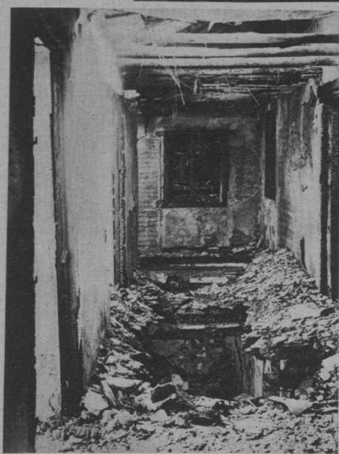
Córdoba.—El fuego ha destruido la fábrica de juguetes. Véase la galería alta de la fábrica, destinada a depósito de juguetes de lujo — (Fot. Santos)
