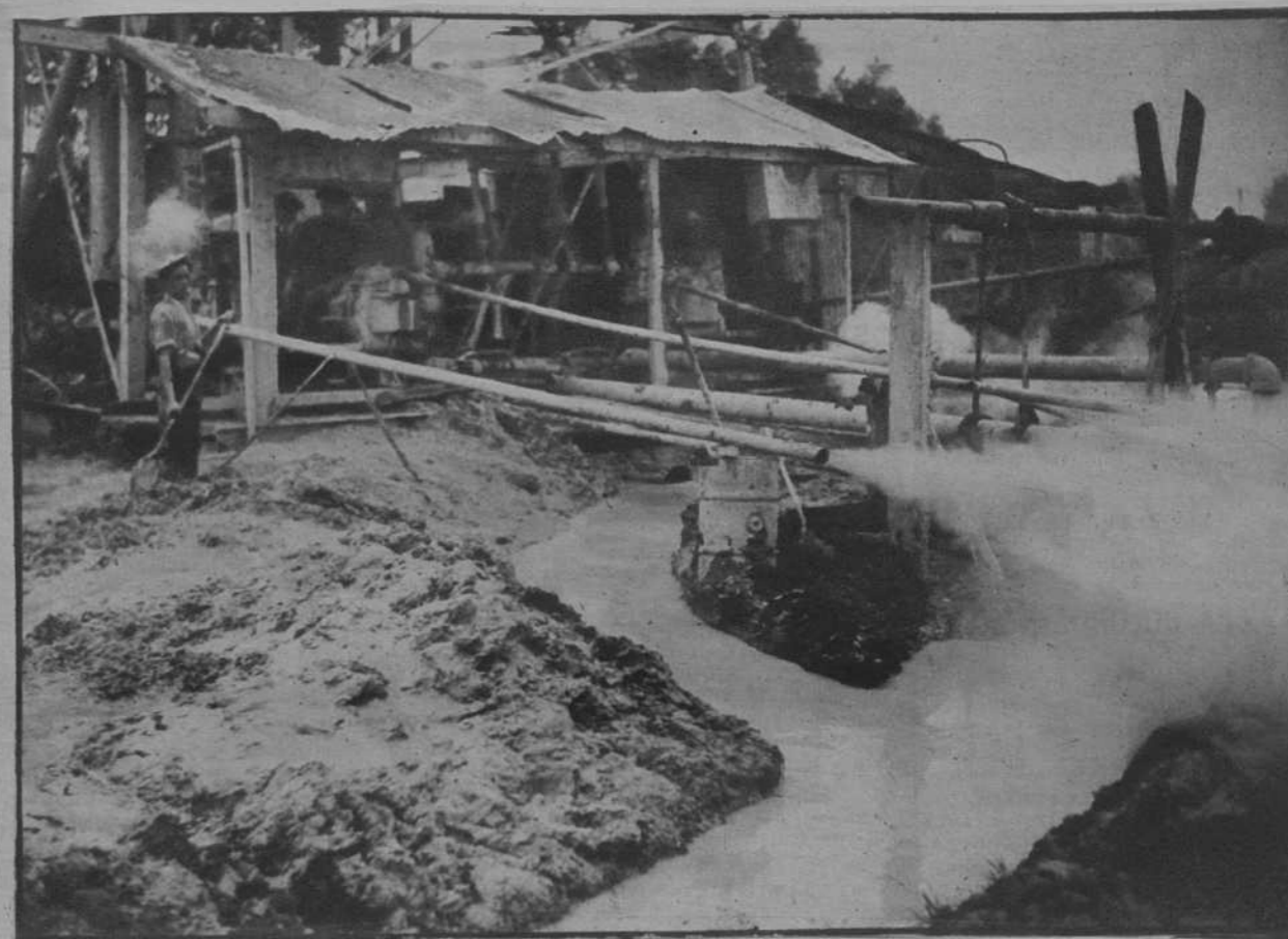
Pozo artesiano de 831 metros de profundidad, para alimentar de agua potable a la barriada N. E. de París
