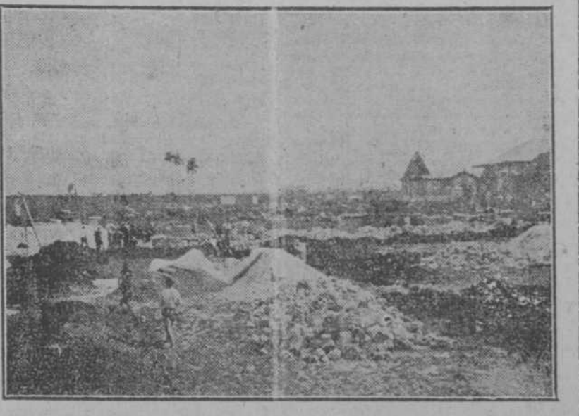
Aspecto general de las obras del nuevo frontón de la Playa, al tiempo de ser colocada ayer la primera piedra.
