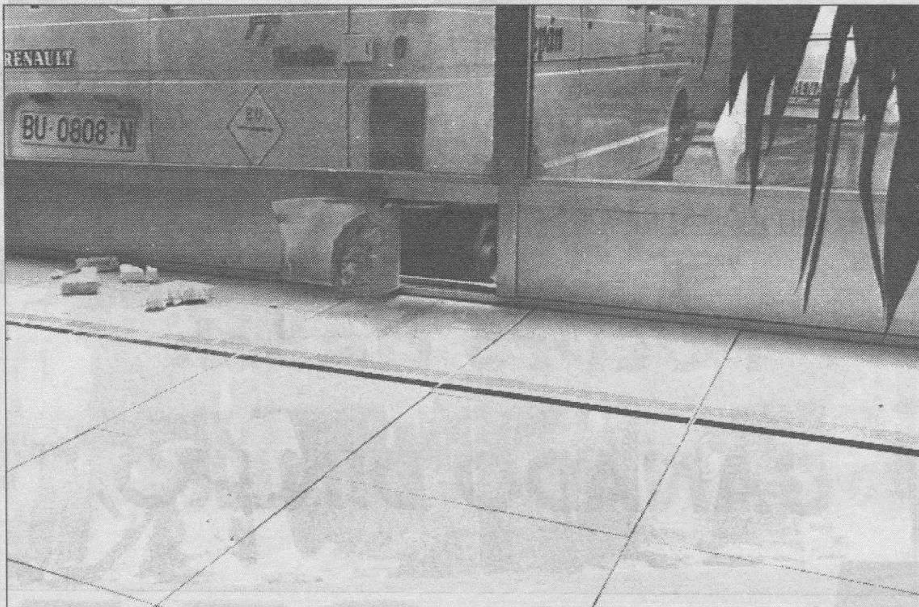
La explosión provocó una pequeña abertura en la estructura metálica del expositor exterior.
