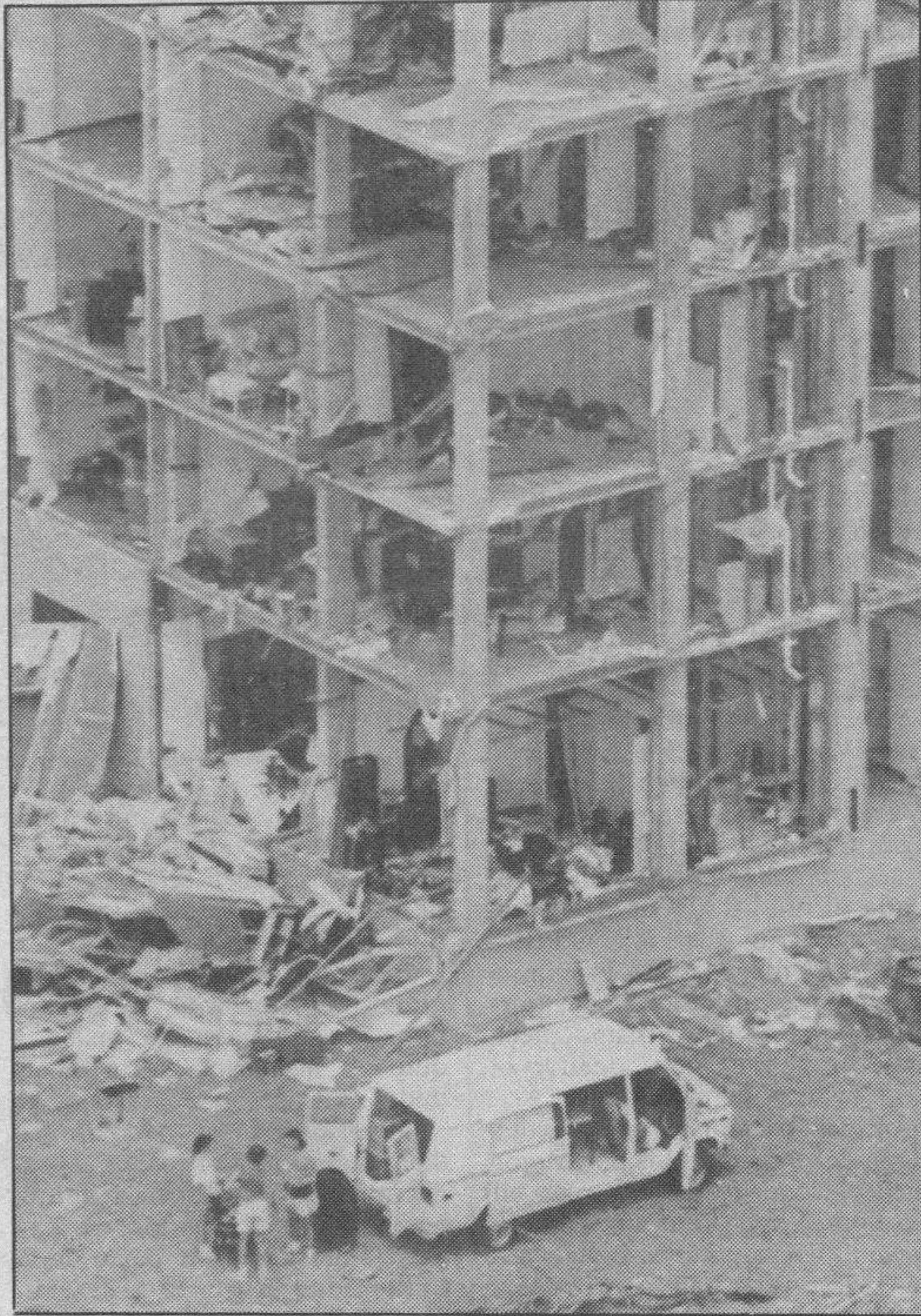
Efectos del tornado en un edificio de Miami.
