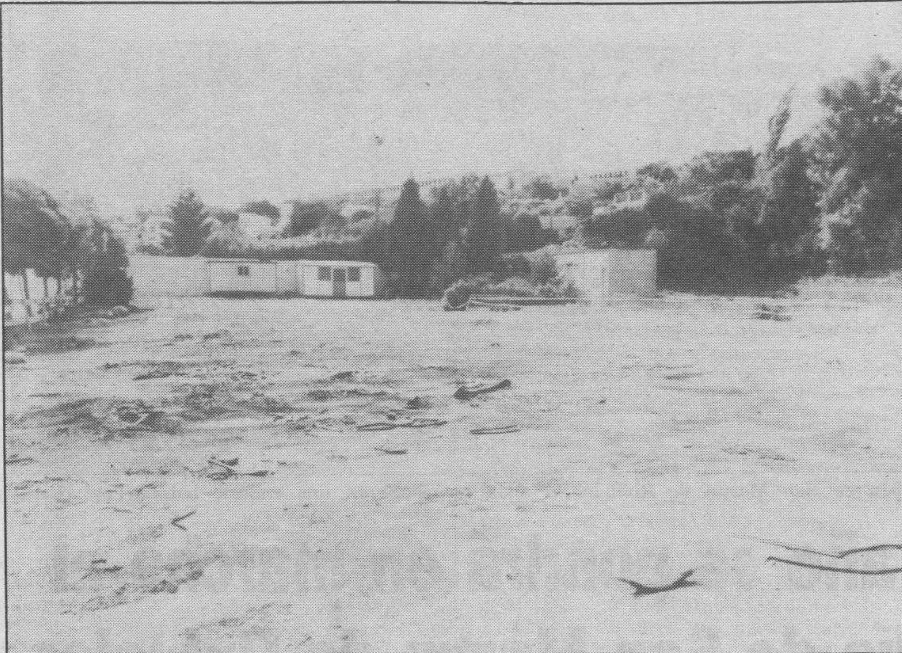
En este solar se han iniciado las primeras tareas de excavación y vaciado. (Foto: Truchuelo).
