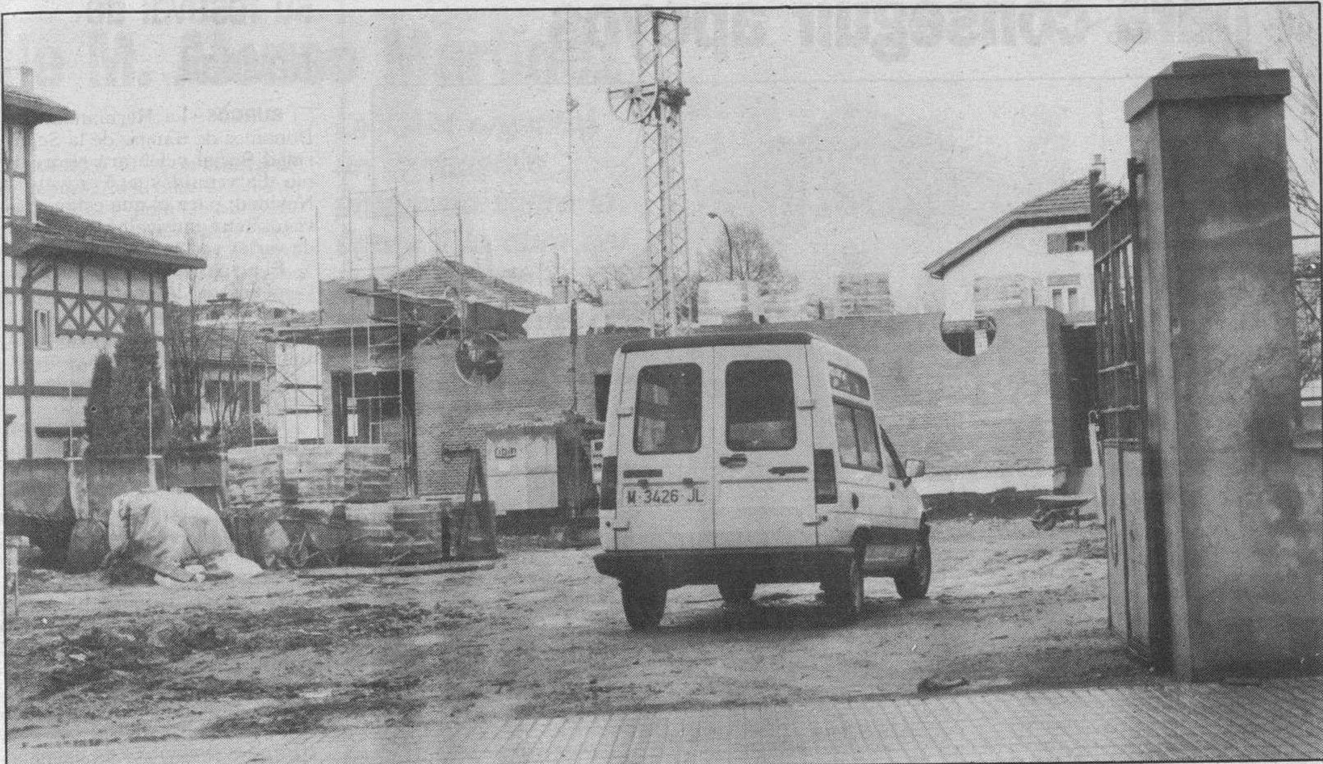
En las obras del «18 de Julio» trabajan algunos albañiles de León. (Foto: J. Matías)
