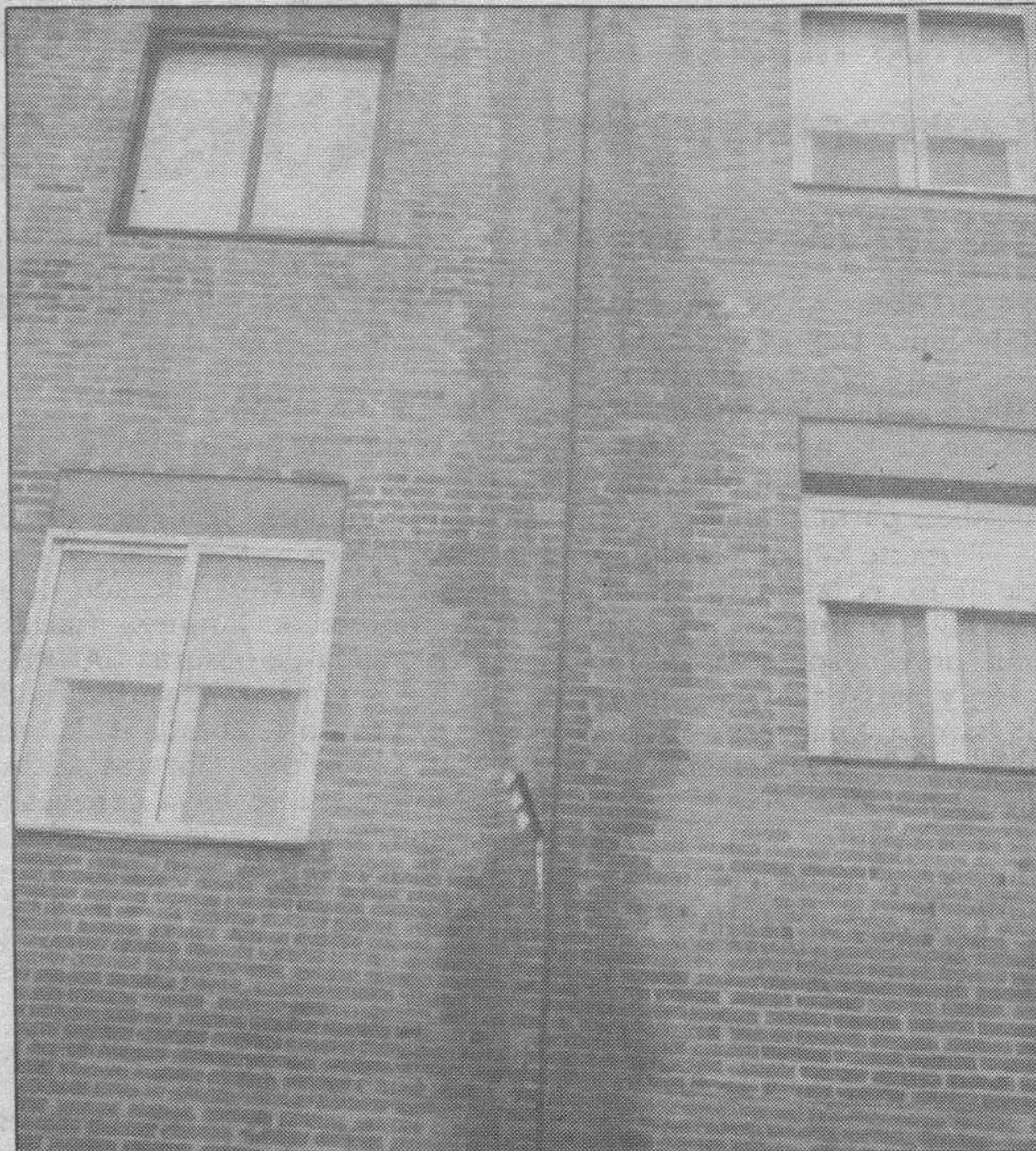
Las humedades se constatan también en otros pisos.
