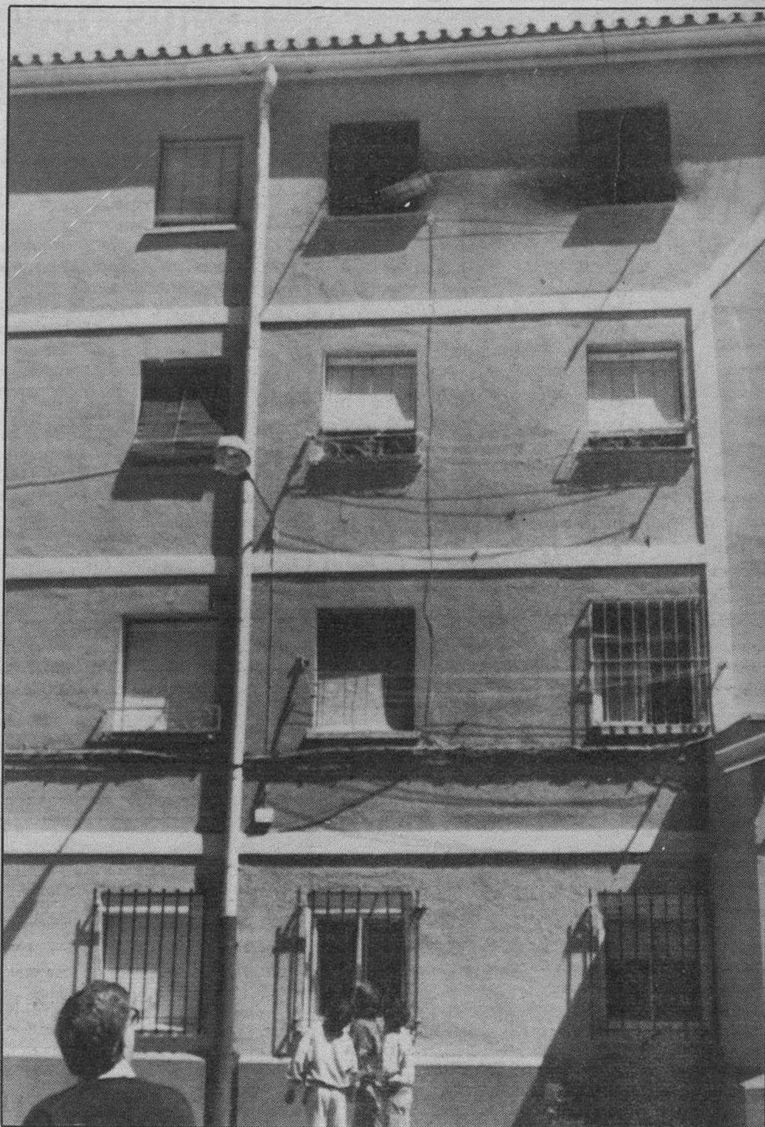
Fachada de la vivienda malagueña de la calle Golondrina, donde un incendio declarado de madrugada causó la muerte de una niña y heridas muy graves a otras 18 personas.- Efe.
