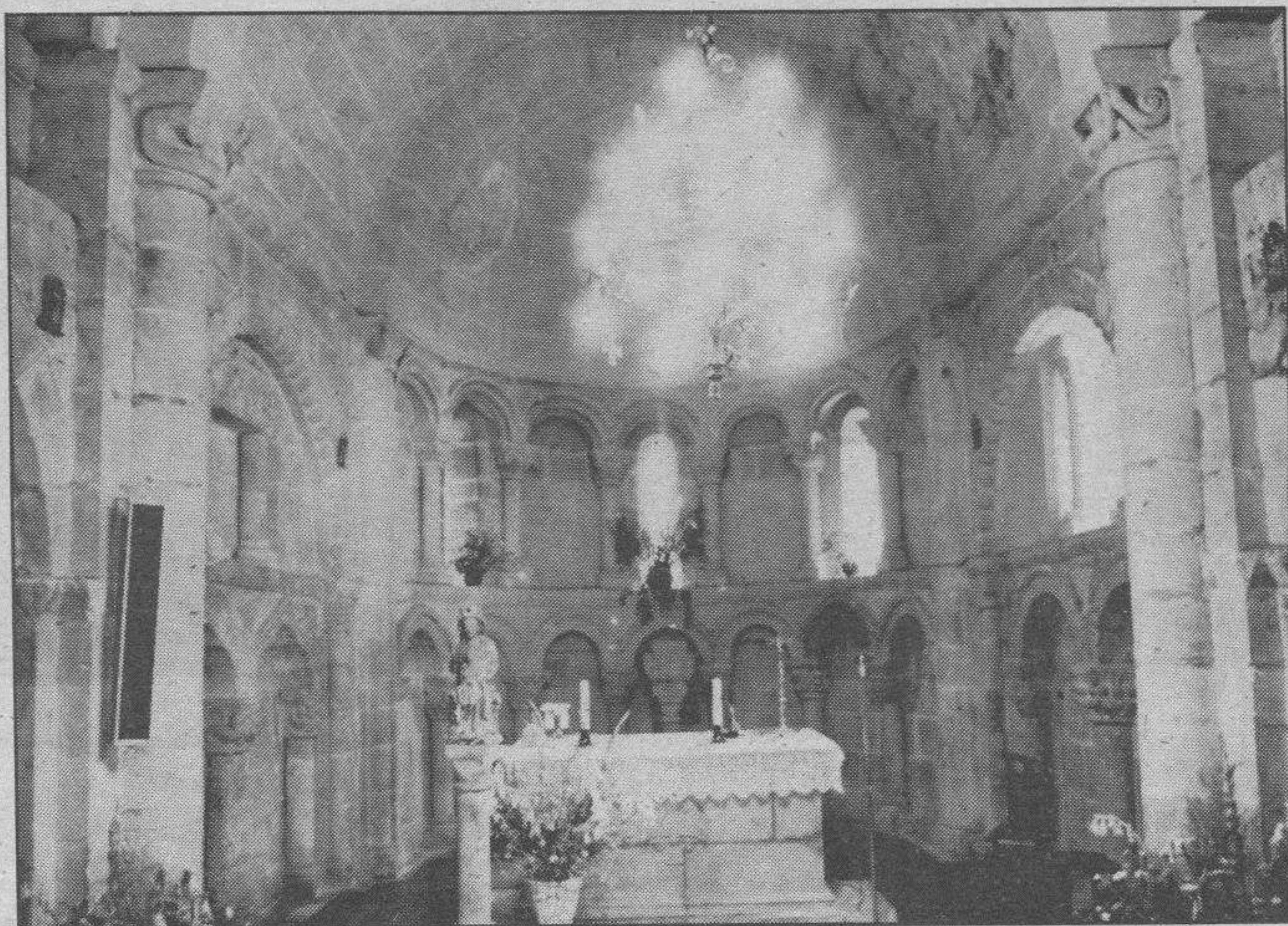
Abside de Santa María, amenazado en su integridad por una grieta. El mal estado de la cubierta está provocando filtraciones que dañan la bóveda. (Foto J. Matías)
