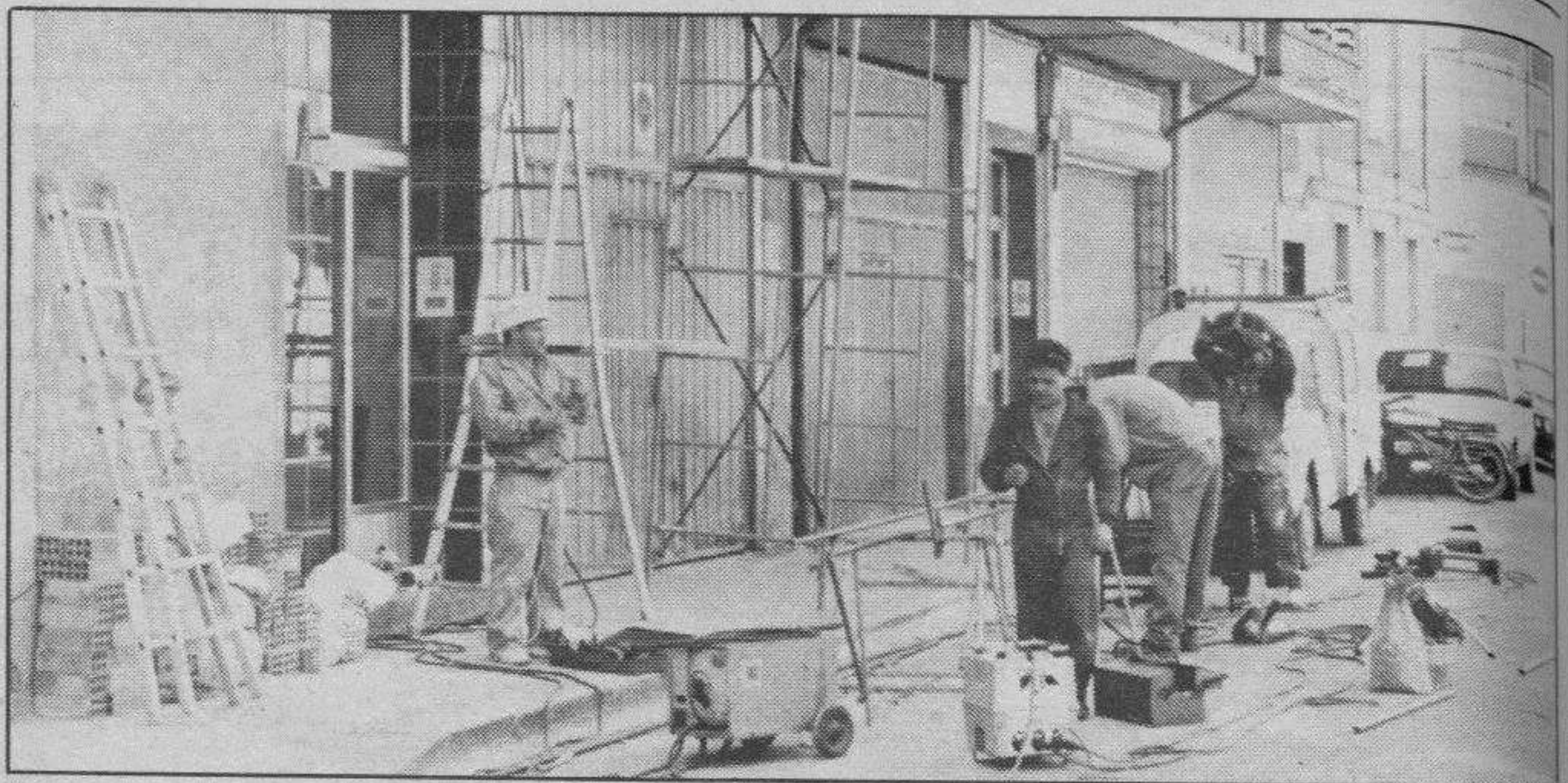
En estos momentos los instaladores trabajan en varias calles de la ciudad. Foto Truchuelo
