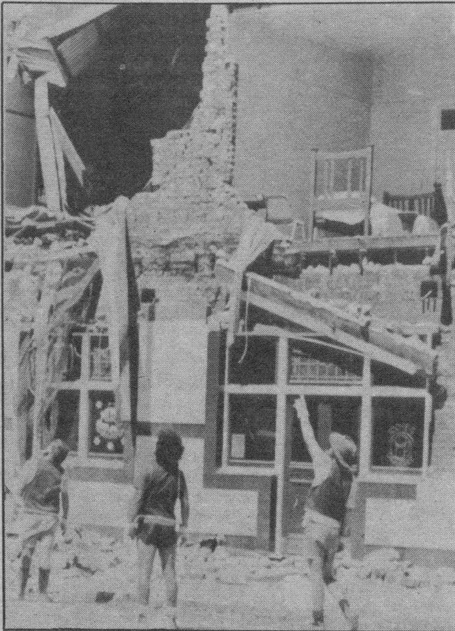
Edificio derrumbado en Newcastle. Reuter/Efe
