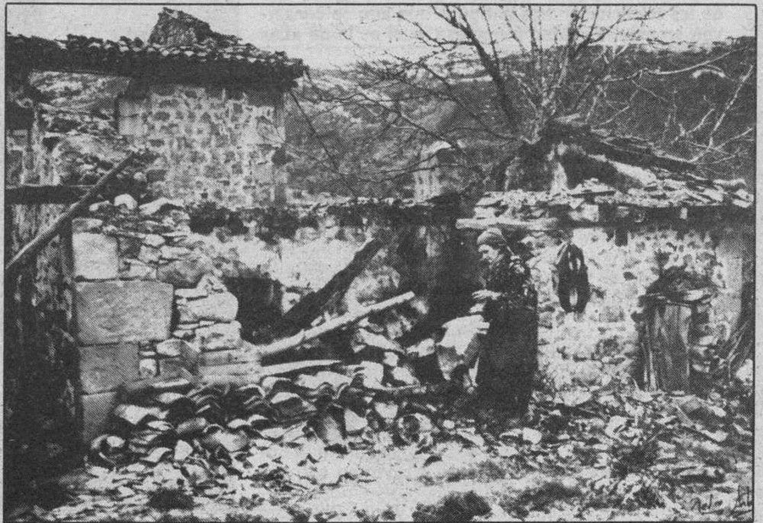
Estado en el que ha quedado uno de los inmuebles destruidos. Foto Pedro Antonio
