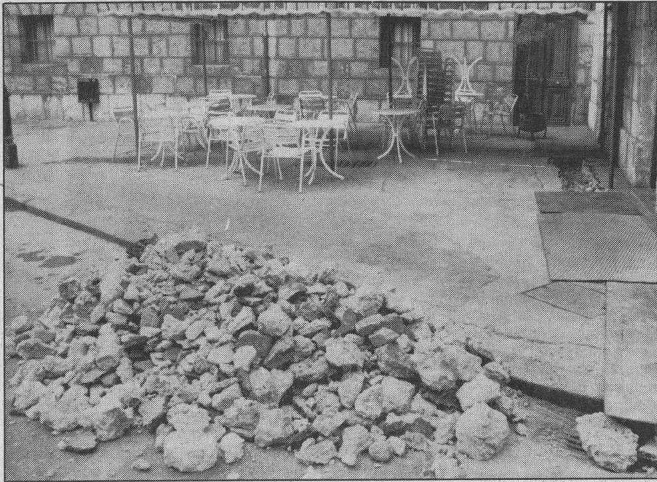
Ayer se reparó el lugar donde se averió la tubería de aguas y se inundó la cabina de Iberduero.
