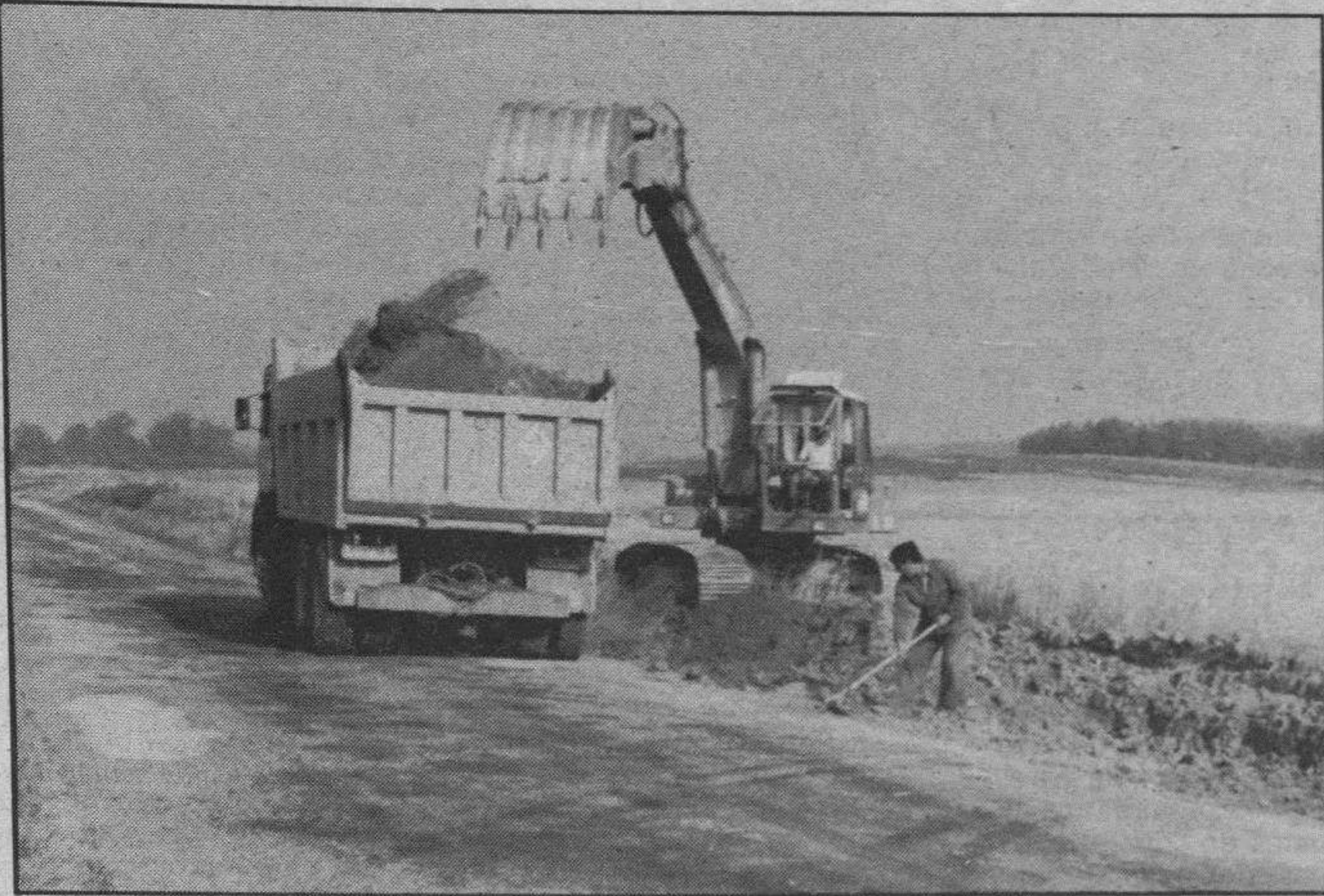
Equipo de operarios y maquinaria. Comienzo del ensanche de la carretera Burgos-Aguilar, junto a Llanillo de Valdelucio.
