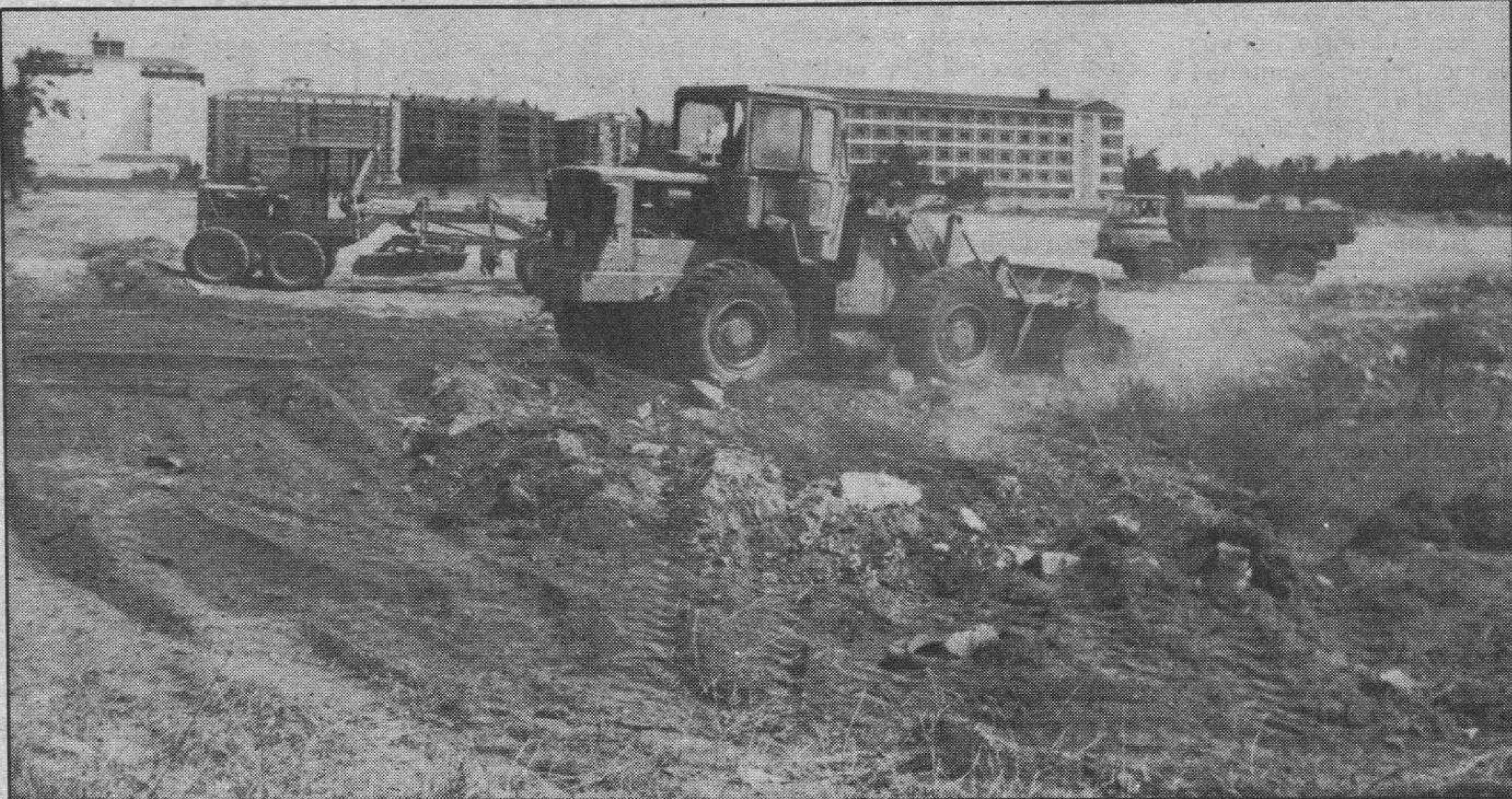
Explanación de terrenos para la instalación de la Feria de la Ribera. Foto Lara.
