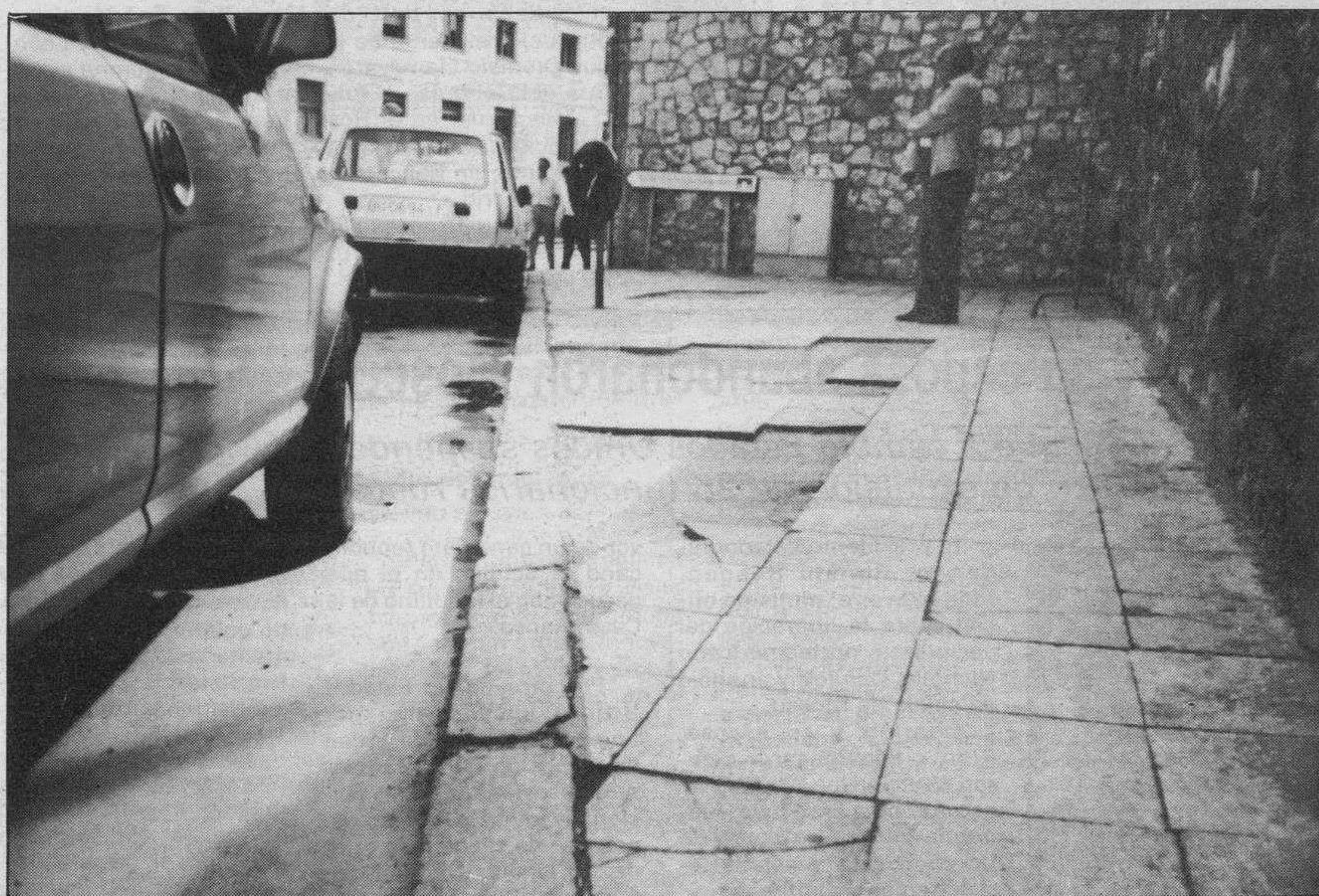
Baldosas sueltas. — Cuando el Ayuntamiento decidió cubrir las aceras de numerosas calles de la ciudad con baldosas, se consideró que era un acierto. Lo seguimos creyendo, pero tiene este inconveniente, que con mucha frecuencia están sueltas o rotas y la reparación no se hace con la celeridad que debiera. Este es un ejemplo frente a la iglesia de San Lesmes. El problema es fácilmente subsanable, pensamos.
