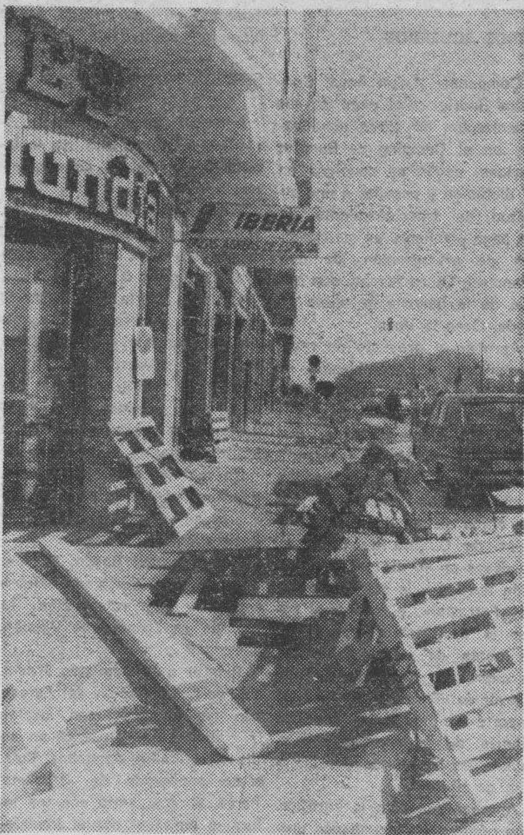
Las obras de pavimentación de la calle de Sanjurjo se llevan a cabo estos días para completar las mejoras municipales de esa zona. — (Foto FEDE).
