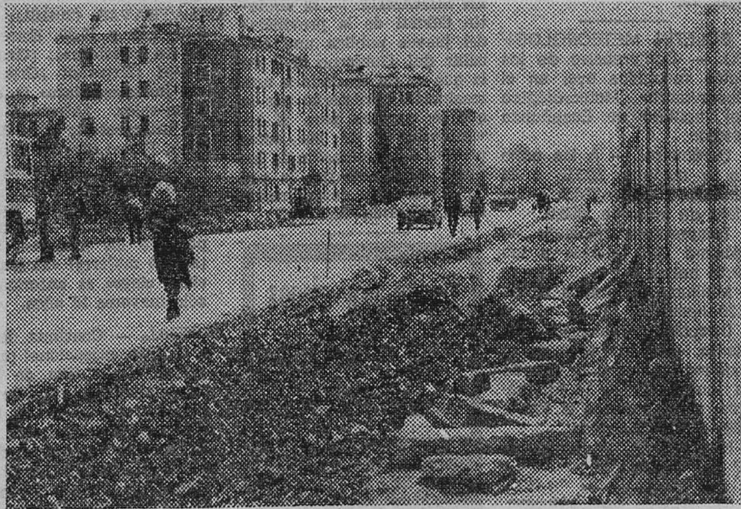
Las obras de mejora del firme de la travesía de la N-1 se llevan a cabo con gran celeridad con el fin de terminarlas en el plazo previsto. Este es un aspecto actual de los trabajos. — (Foto FEDE).
