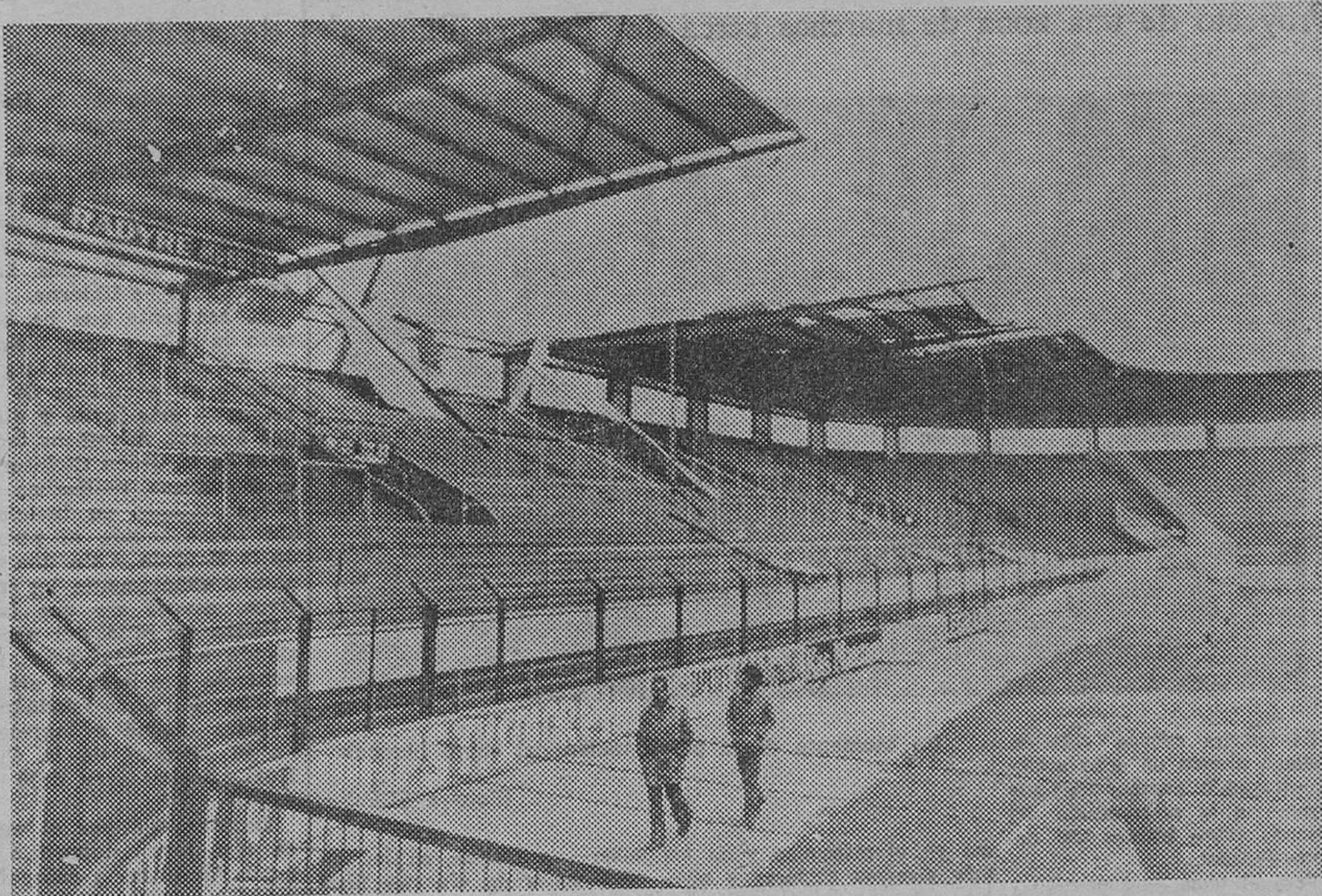
Salamanca. — En vísperas del encuentro internacional España-Chipre, que se jugará mañana, en el estadio «Helmántico», se ha venido abajo parte de la techumbre que cubre la parte Norte de las gradas, debido al fuerte viento que azotó la ciudad. — (Telefoto EFE-UPI)
