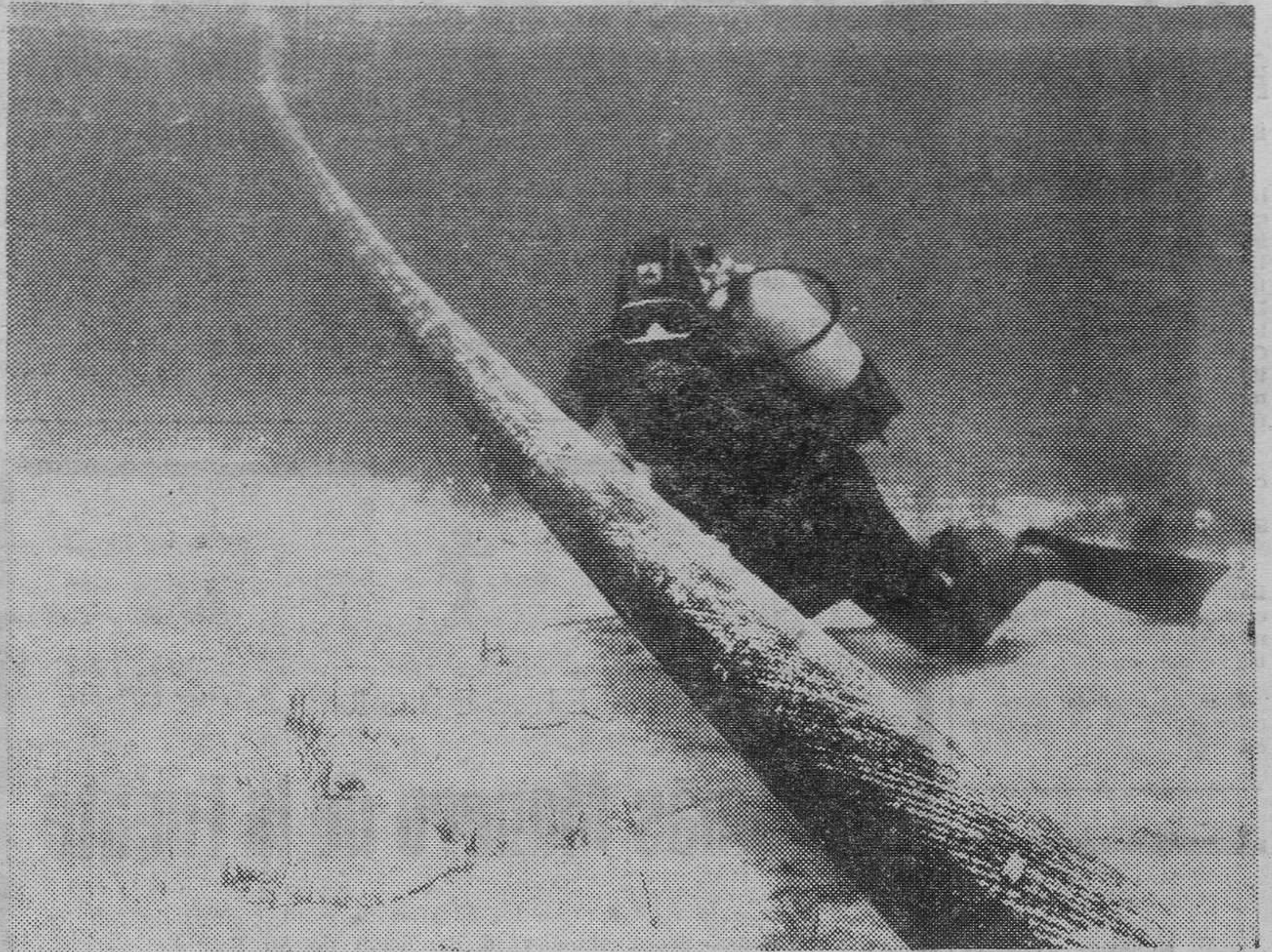
Roma. — En la Isla de Cerdeña falta agua. La que dispone es insuficiente y ha habido necesidad de recurrir a los métodos más modernos para su abastecimiento. Uno de ellos ha sido la instalación de una tubería submarina especial. La foto capta a un hombre rana instalando una tubería entre Calasetta (Istmo de San Antioco) y Carloforte (Isla de San Pietro, en Cerdeña). — (Foto Cifra Gráfica)
